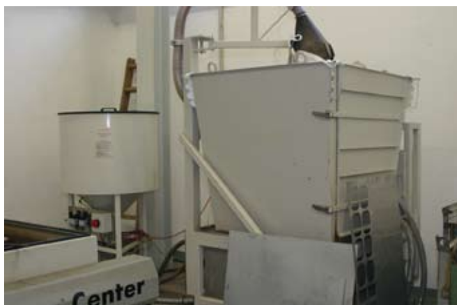
Sandzufuhr und Schlammabsaugung erfolgen automatisch – der handlingsaufwand beschränkt sich auf ein Minimum.
